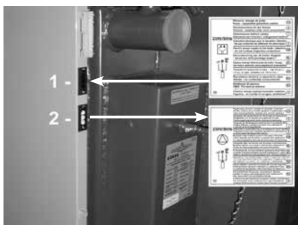
Steckverbindungen in der rechten Kesselabdeckung
